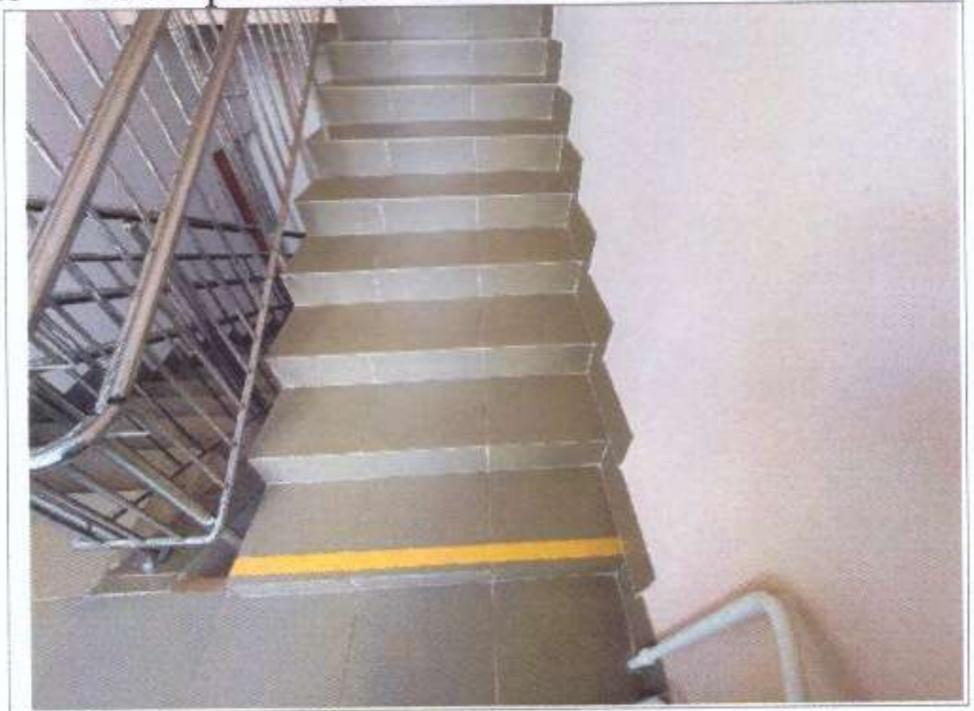
Фото № 14 - Пути движения внутри здания (лестница). Контрастно выделены первая и последняя ступени марша лестницы.
