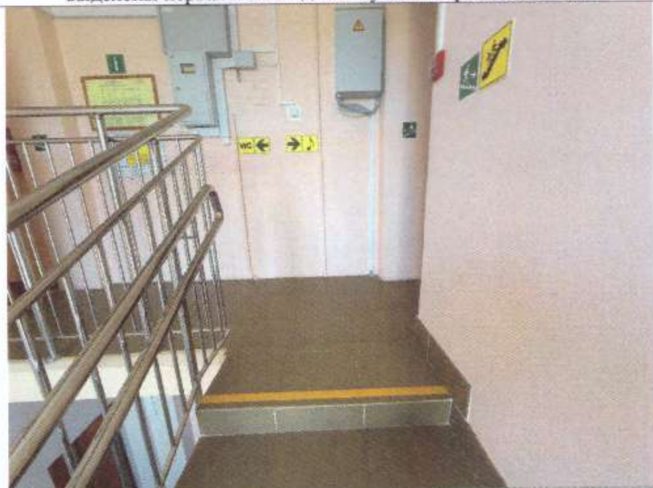
Фото № 15 - Пути движения внутри здания (лестница). Контрастно выделены первая и последняя ступени марша лестницы.
