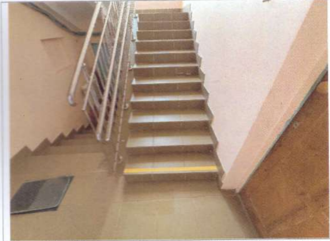
Фото № 13 – Пути движения внутри здания (лестница). Контрастно выделены первая и последняя ступени марша лестницы.
